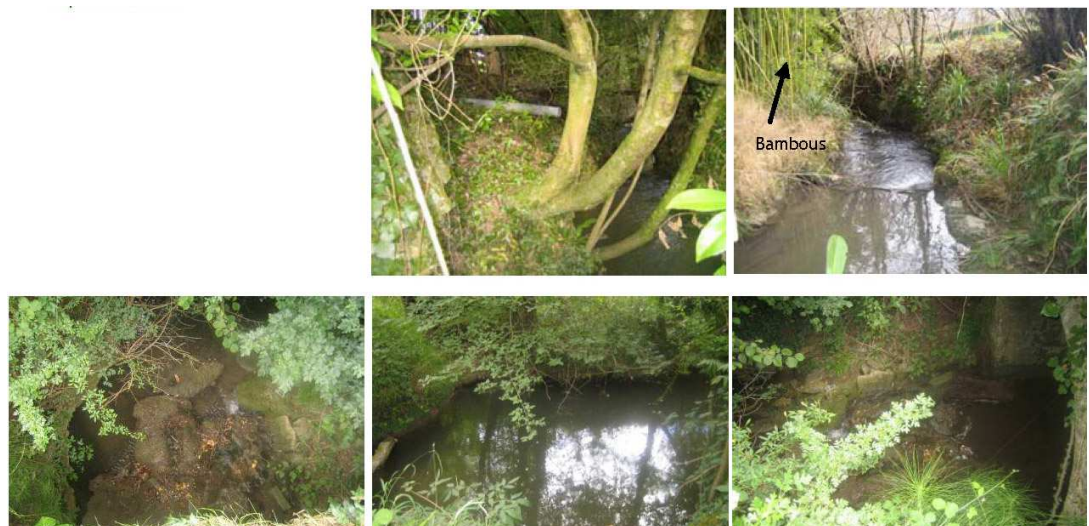
Etat des ripisylves du Canterane à Cassignard : présence d'espèces indésirables (bambou), berges sous-cavées, tuyau d'arrivée d'eau, arbres penchés, encombrement du lit
